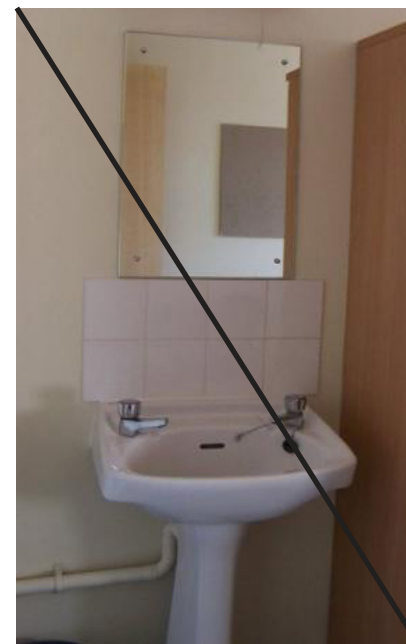
Плохо Раковина с пьедесталом. Фартук из плитки
